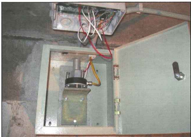
Рис. 7. Инклинометр в защитном шкафу на несущих конструкциях
