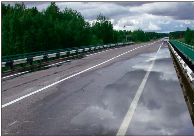
Рис.3. Несовпадение фактических уклонов моста с проектными при отсутствии водоотводных трубок, не предусмотренных проектом и, как следствие, застой воды
