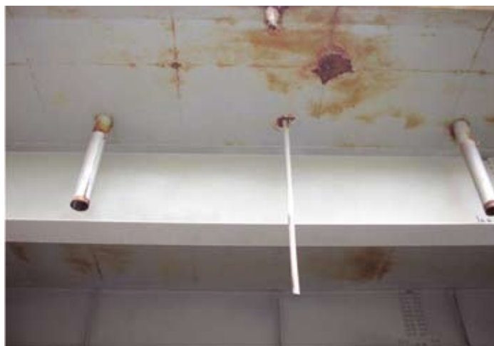
Рис. 3. Последствия использования для опалубки неизвлекаемых стальных поддонов через 9 лет эксплуатации моста
